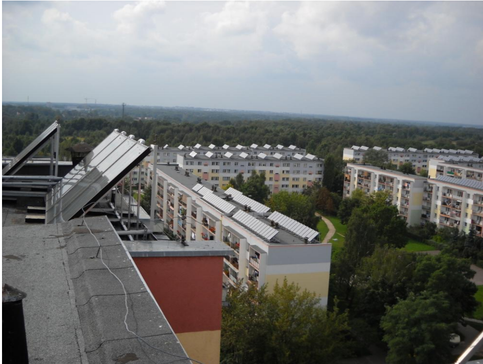
Fot. Kolektory słoneczne Łódź - Osiedle Radogoszcz Zachód
