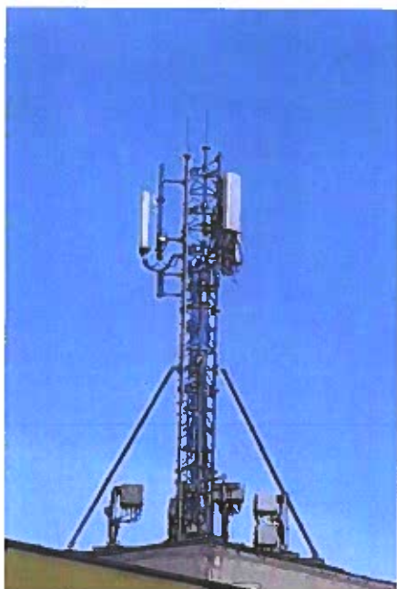
Stacja bazowa telefonii komórkowej umieszczona na dachu budynku
