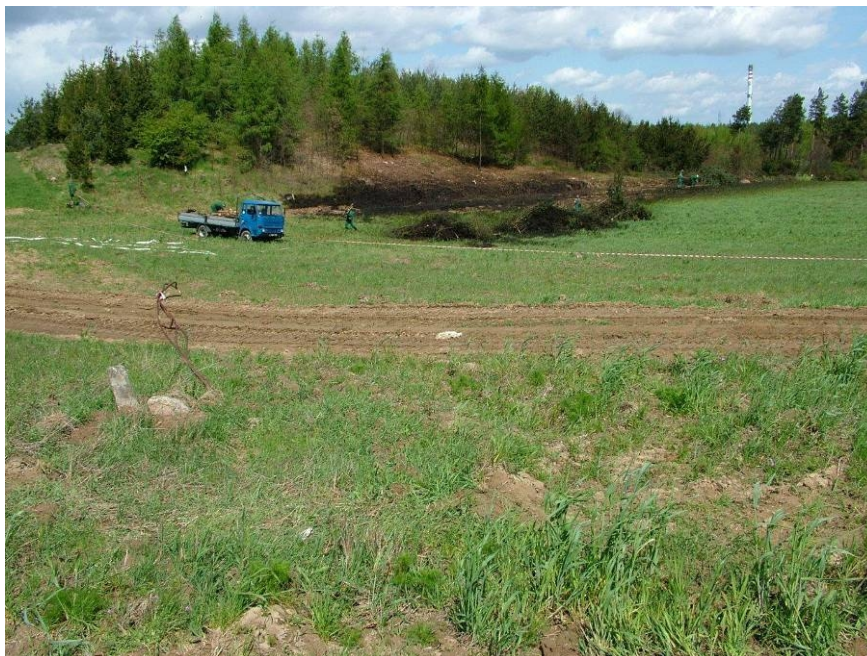
Fot. 2. Widok ogólny na rejon miejsca wycieku
