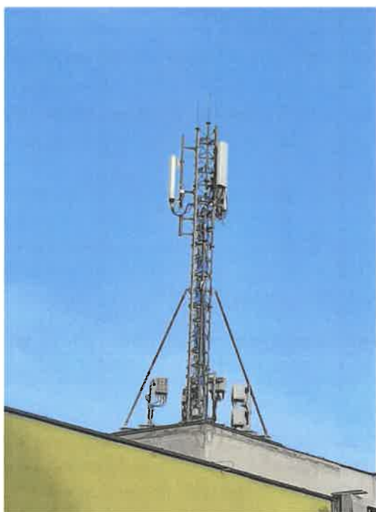
Stacja bazowa telefonii komórkowej umieszczona na dachu budynku
