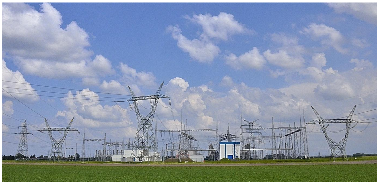
Rys. 2.1.3 Okolice Warszawy. Widok stacji elektroenergetycznej Oltarzew 400/220/110 kV, wraz z przyłączonymi liniami 400 kV, 220 kV i 110 kV. Fot. Stefan Różycki
