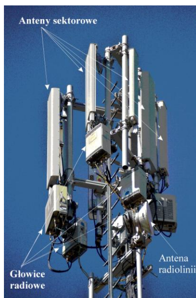
Rys.2.2.2 Anteny stacji bazowej telefonii komórkowej. Fot. Stefan Różycki
