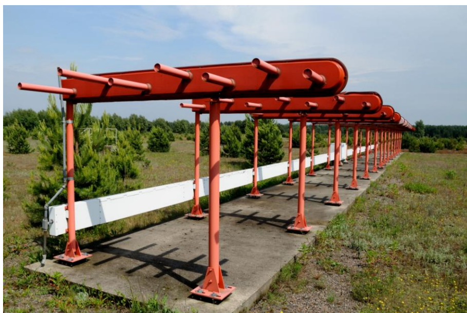
Rys. 3.2.4 Radiolatarnia kierunku systemu ILS ( Instrumental Landing System ).
