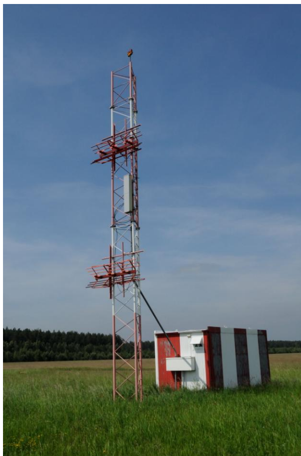
Rys. 3.2.5 Radiolatarnia ścieżki zejścia systemu ILS ( Instrumental Landing System ). Fot. Stefan Różycki
